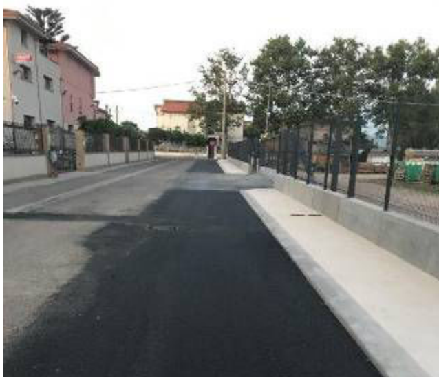
Situazione esistente marciapiede Via Udine
